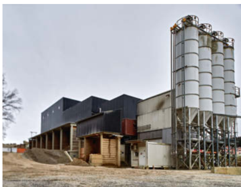
Juste à côté du chantier: gravière et centrale à béton pour la construction du tunnel ferroviaire de Rosshäusern.
