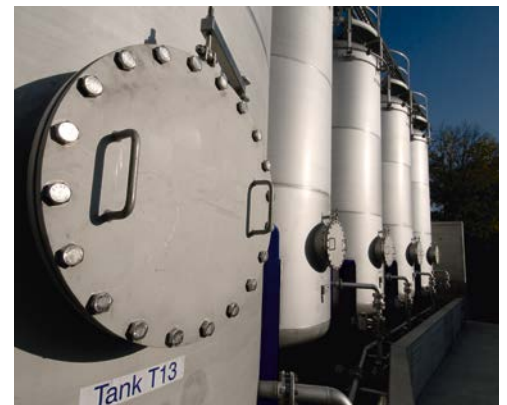
Bei Altola werden entzündliche Flüssigkeiten sicher gelagert.
