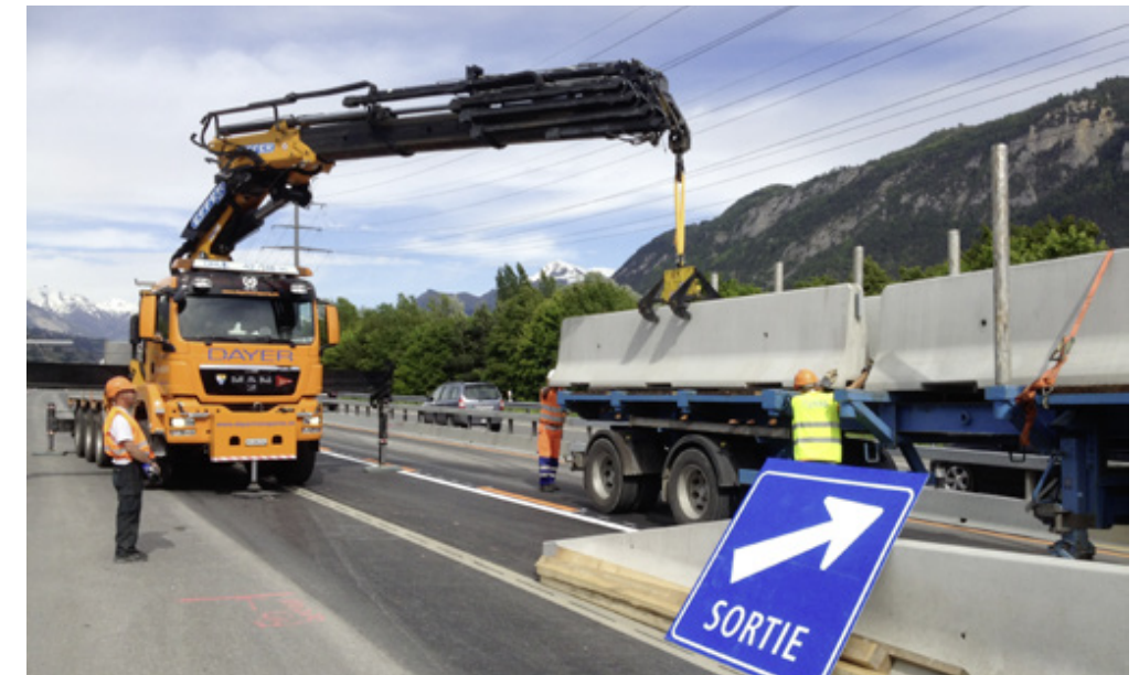
Centre vital valaisan: L'autoroute A9 est équipée du système de retenue DELTA BLOC®.
