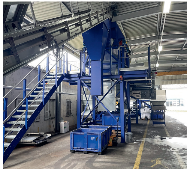
Sicherheit geht vor: Das Förderband der mechanischen Verarbeitungslinie für E-Schrott verfügt über eine Löschleitung.
